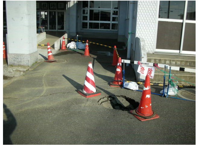
(城南中学校昇降口の沈下被害)
