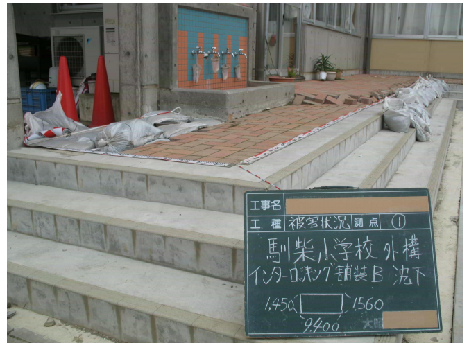
(馴柴小学校外構の損傷)
