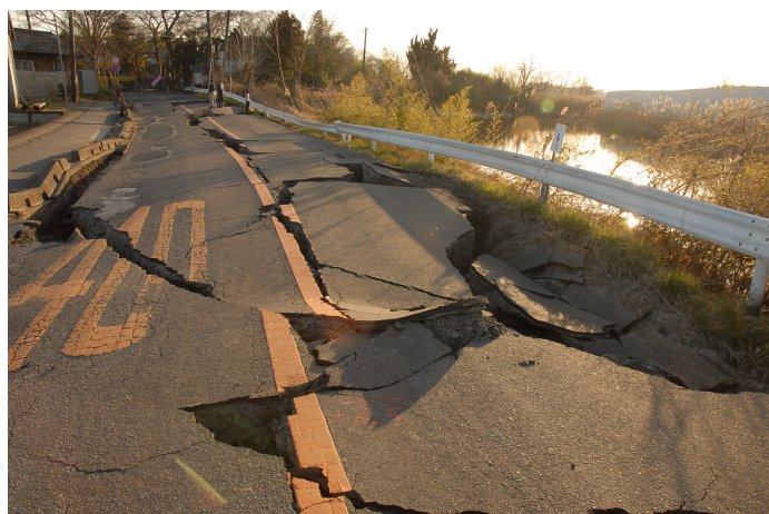
(長沖町の道路損壊)
