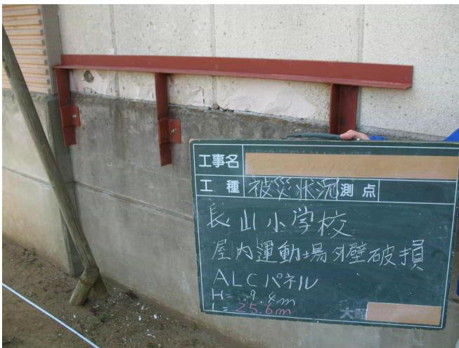
(長山小学校体育館外壁の損傷)
