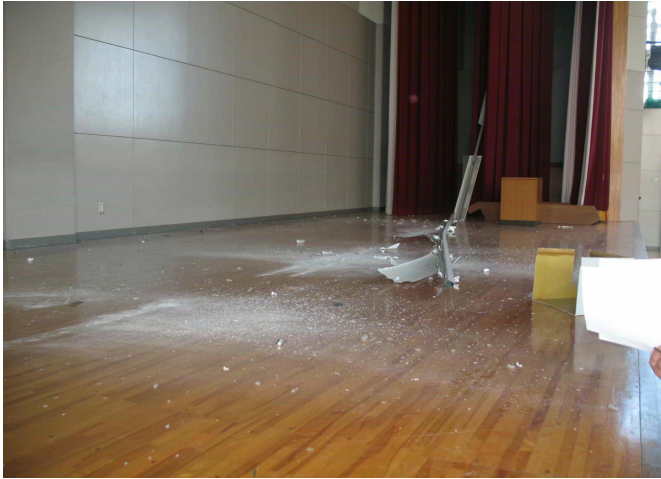
(愛宕中体育館ステージ，照明器具等落下)
