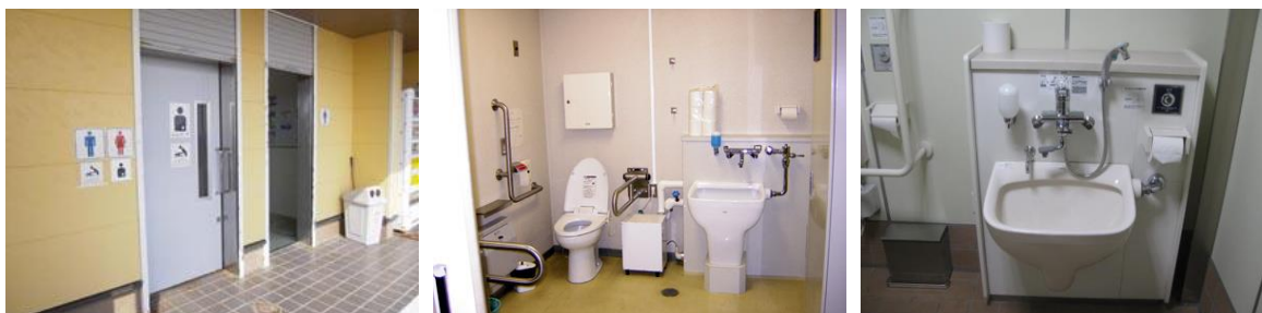
図－3. 多機能（オストメイト（人工肛門）対応型）トイレの整備事例
