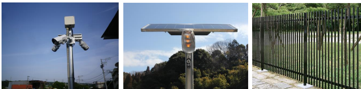
防犯カメラ（モニターは事務室） 屋外照明（防犯灯） 進入（転落）防止フェンス
